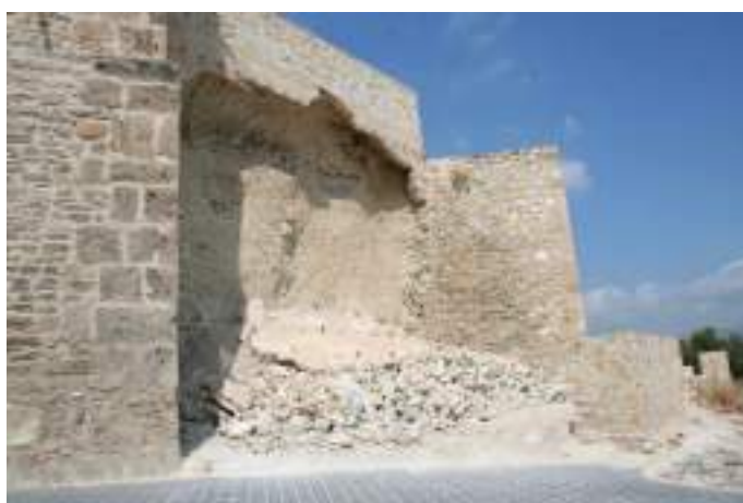
Fotos 6.- Desplome del lienzo de muralla entre la Torre de la Magdalena y la Torre del Mirador ocurrido en junio de 2007.
