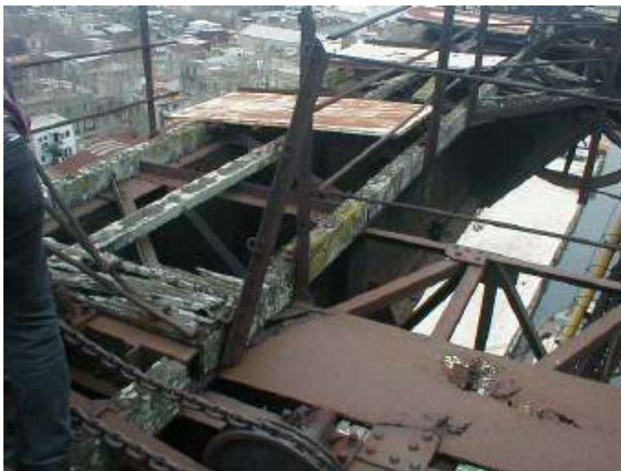
FOTO 4.-Deterioros del Puente.
