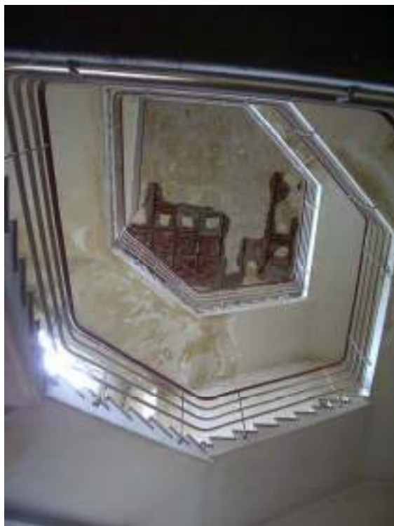
Figure 8 , Scala esagonale, particolare del solaio degradato con ferri ossidati
