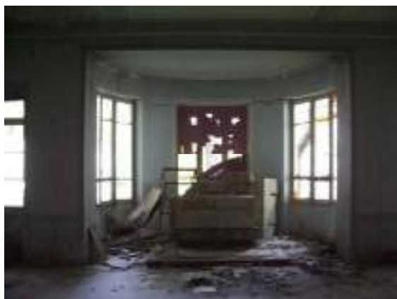
Figure 11 , Interno dall'esedra, lesioni orizzontali
