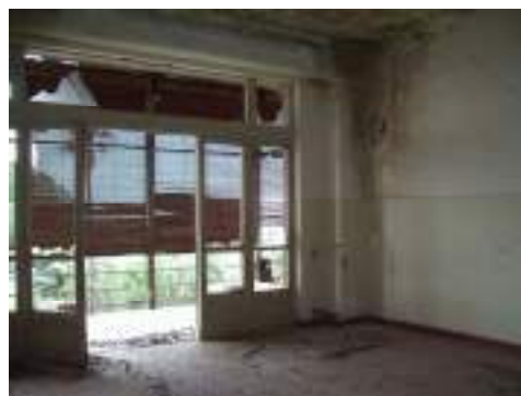
Figure 12 , Vano interno: segni di degrado da umidità per infiltrazione
